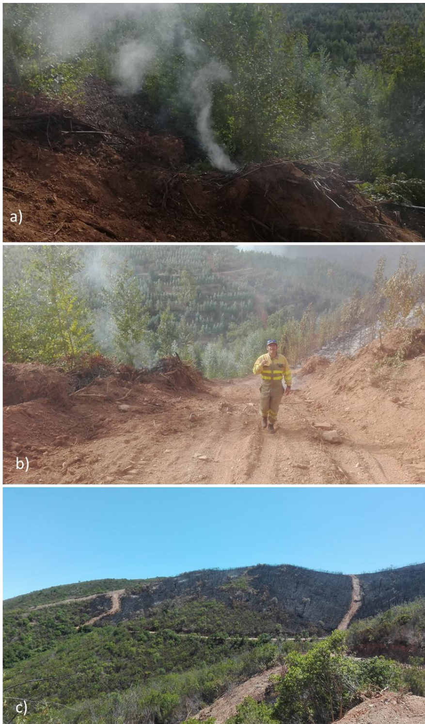
Figura 23. a) Ponto quente na área verde (ainda não ardida) por arrastamento de material em combustão pela abertura de linha de defesa com máquina de rastos; b) Parte da área ardida (em combustão) do lado esquerdo da foto ficou do lado de fora da linha de defesa aberta pela máquina de rastos; c) Linha de defesa aberta com máquina de rastos ultrapassada duas vezes por deixar material ardido do lado de fora da linha. Fonte: AFOCELCA.
