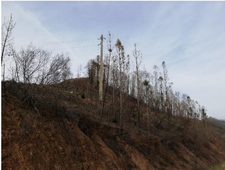
Figura 10. Local indicado como provável início do incêndio (Lat: 37.396944, Long: -8.588963; registo SGIF) debaixo de uma linha elétrica de média tensão (15kV), gerida pela EDP.
