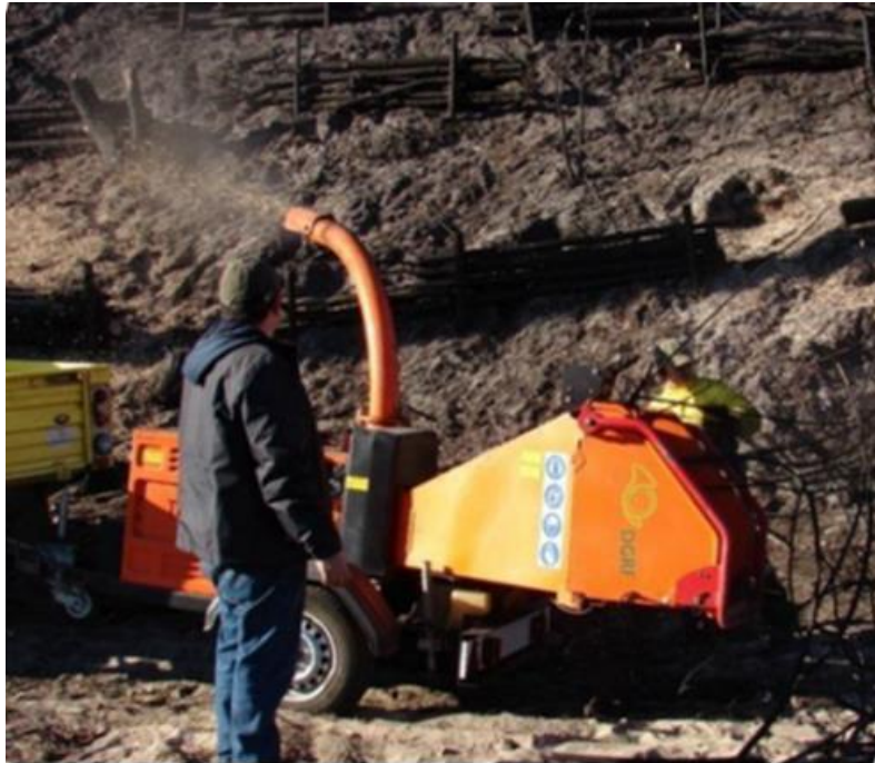
Figura 4. Instalação de barreiras de troncos, combinadas com acolchoado de estilha nas margens do Ribeiro de S. Pedro de Moel. Fonte: Keizer et al. (2018).
