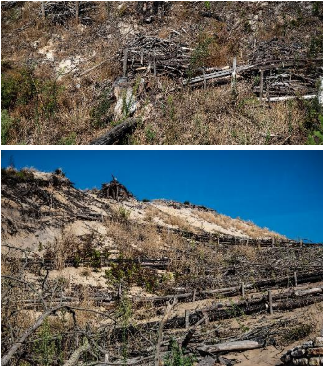
Figura 7. Construção e colocação deficientes das barreiras de troncos, resultando num amontoado anárquico 3 anos depois. Fotos OTI, setembro de 2020.
